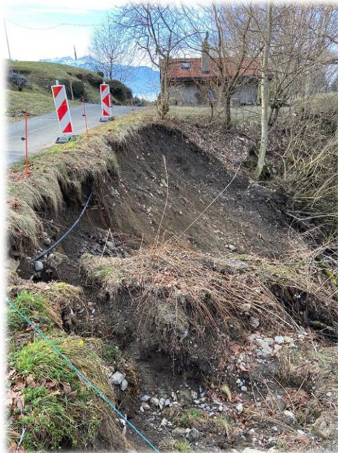
Glissement de terrain au Ch. de la Combaz-Teysaz
